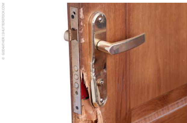
Figura 1.5 – Porta e maçaneta danificadas (possivelmente arrombada).
